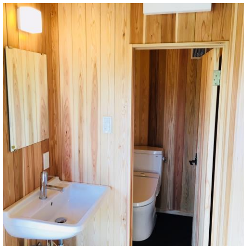
トイレ&洗面スペース
